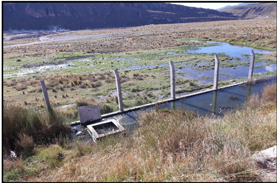
Figura 28: El efluente de la PTAR de la laguna de maduración se encuentra colmatada y en malas condiciones y no está operando correctamente.
