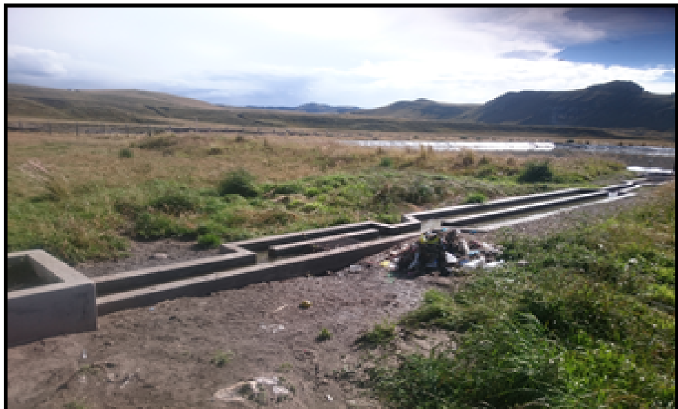
Figura 24: Cámara de rejas con residuos sólidos al costado y desarenador, por donde está pasando el desagüe crudo, presentado desbordes del agua residual hacia los lados del canal.
